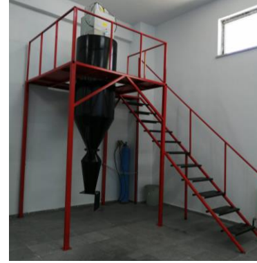
Toz metal üretim tesisi (gaz atomizasyon)
